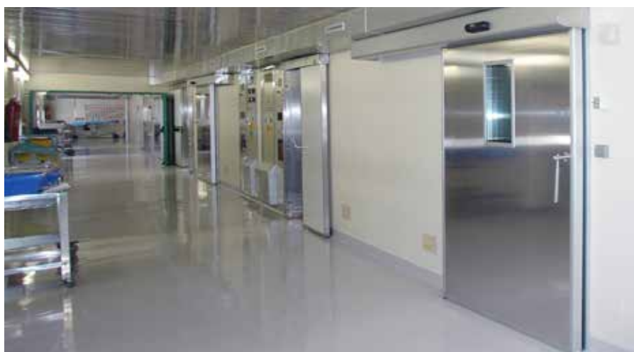
Corridoio reparto operatorio con porte PSE Inox con carter a 45° idoneo per pulizia
