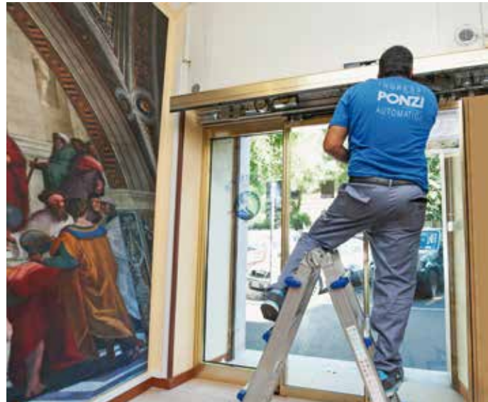
Intervento di un tecnico specializzato Ponzi sulla parte elettronica di una porta automatica scorrevole
